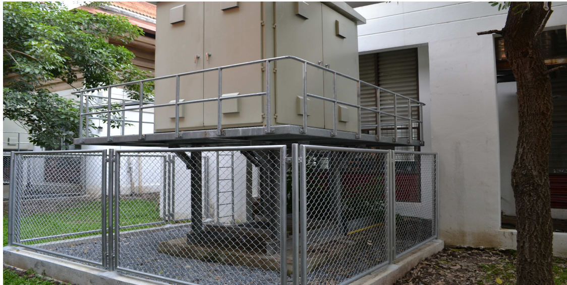
Load Break Switch ,Oil Type Transformer 160 KVA อาคารปฏิบัติการวิศวกรรมอุตสาหกรรม (สูง 2 เมตร จากระดับถนน)
