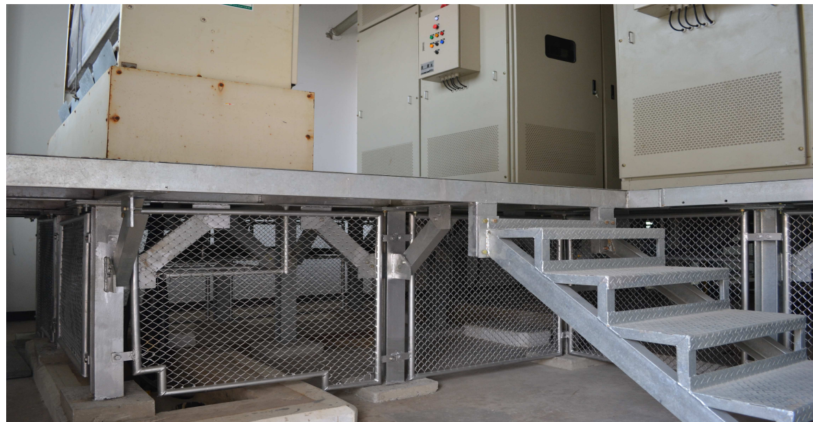
RMU, MDB, Dry Type Transformer 1600 KVA อาคารปฏิบัติการและวิจัย (สูง 1.20 เมตร จากระดับพื้นอาคาร)
