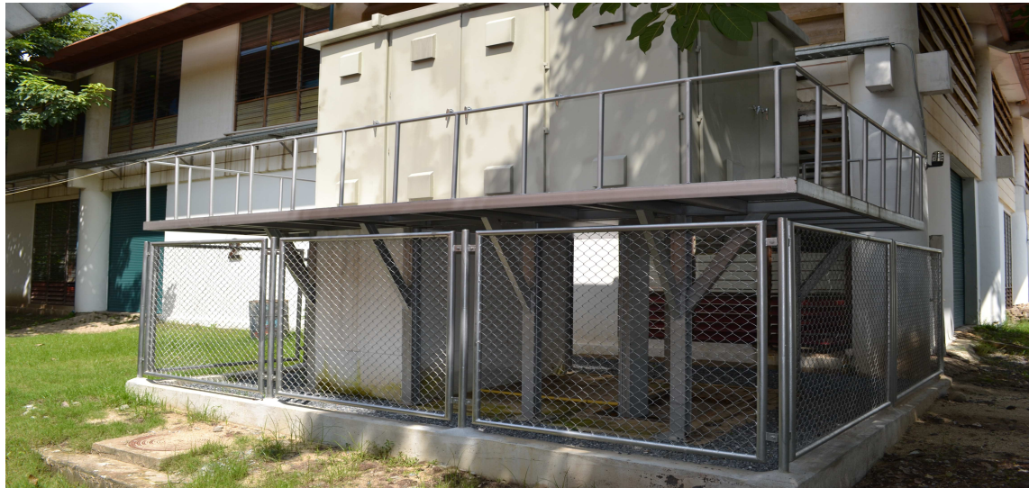
RMU, MDB, Dry Type Transformer 500 KVA อาคารปฏิบัติการวิศวกรรมโยธา และวิศวกรรมเครื่องกล (สูง 2 เมตร จากระดับถนน)
