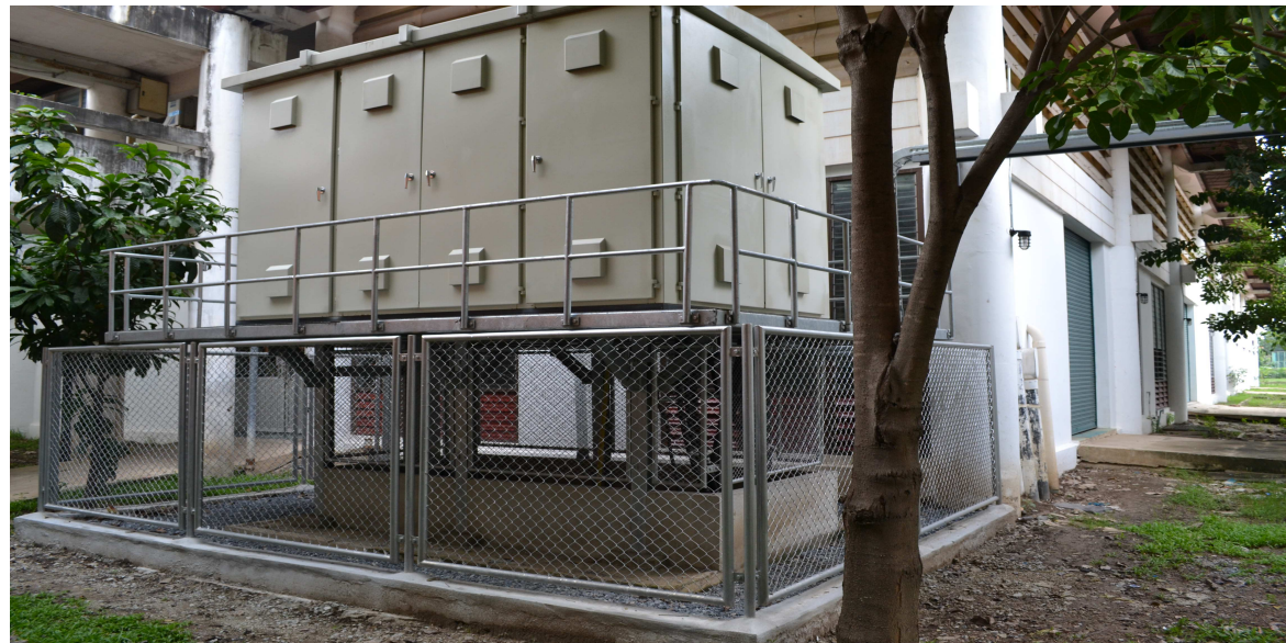
RMU, MDB, Dry Type Transformer 500 KVA อาคารปฏิบัติการวิศวกรรมอุตสาหกรรม (สูง 2 เมตร จากระดับถนน)
