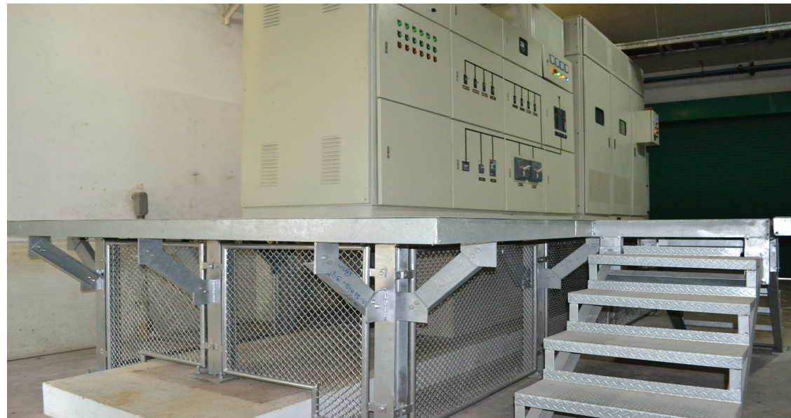
RMU, MDB, Dry Type Transformer 1500 KVA อาคารอำนวยการคณะวิศวกรรมศาสตร์ (สูง 1.20 เมตร จากระดับพื้นอาคาร)
