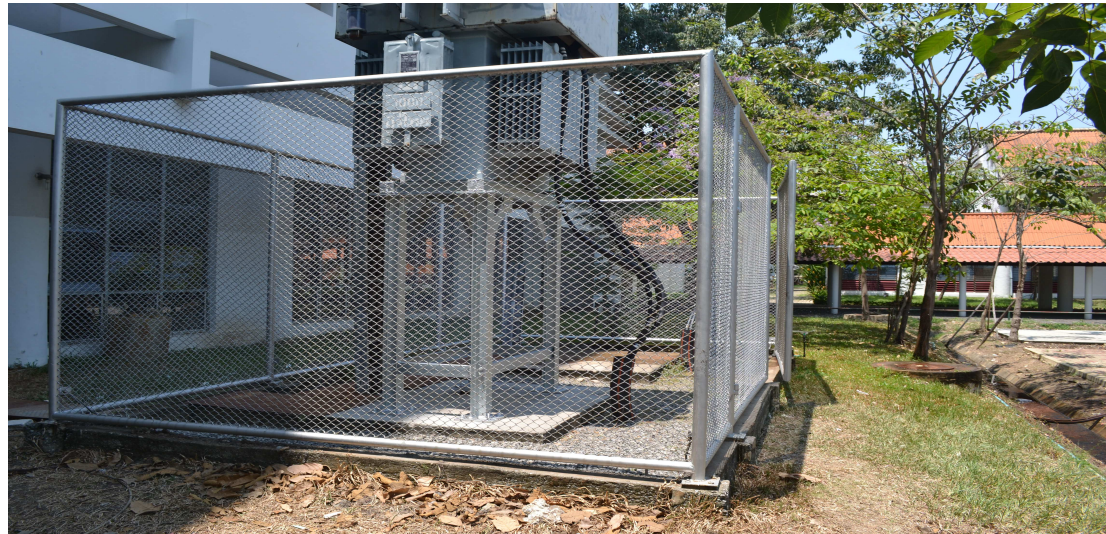
Oil Type Transformer 1000 KVA อาคารอำนวยการคณะวิศวกรรมศาสตร์ (สูง 2 เมตร จากระดับพื้นอาคาร)
